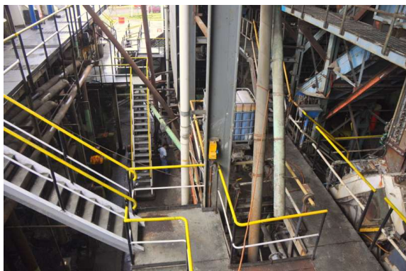
pa po štengah gor, pa po štengah dol, vse rjasto, umazano, ne veš, če ne bo vse skupaj prej razpadlo ...
