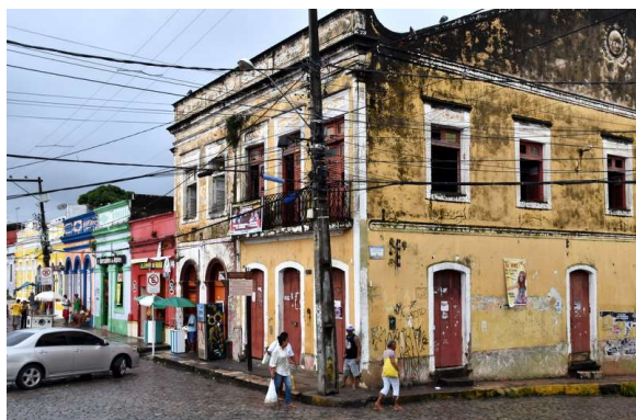
vlaga in vročina hitro uničujeta stavbe
