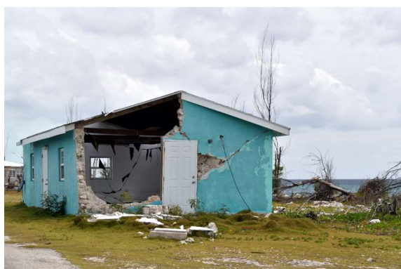
zidana hiša, pa jo je lanski hurikan kar dobro poškodoval
