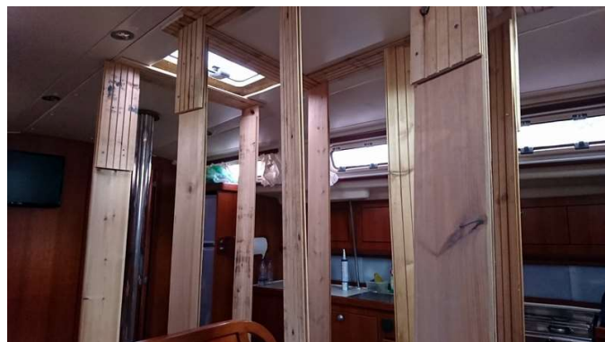
še zadnji del barikad / podpornikov stropa
