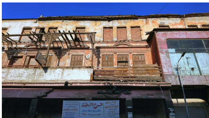
ogromno stavb je razpadajočih, pa čeprav ljudje še vedno živijo v njih
