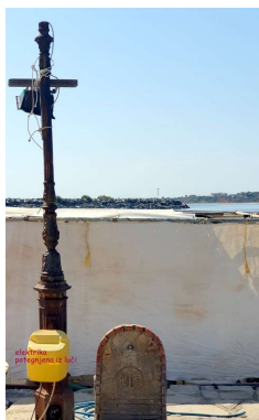
na sosednjem pomolu takole zgledajo priključki za elektriko(kar iz luči ven potegnjene žice) in vodo
