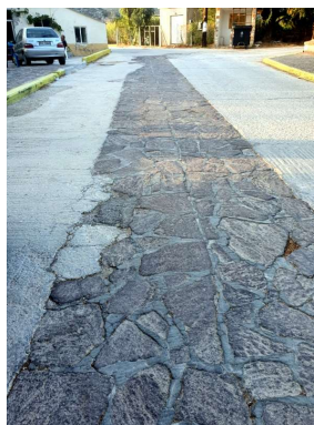
nekoč so bile verjetno kamnite plošče, potem je bilo treba kaj popravljati, pa so samo zalili beton ...
