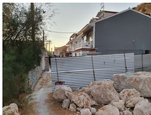
mogoče so kamenje malo bolj na stran dali, druge sanacije ni bilo opravljene po plaz
