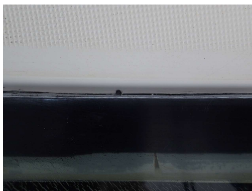
Pod tesnilom se vidi luknje v palubi, ki so verjetno nastale v proizvodnji, ko so upognjeno šipo lepili na palubo.
