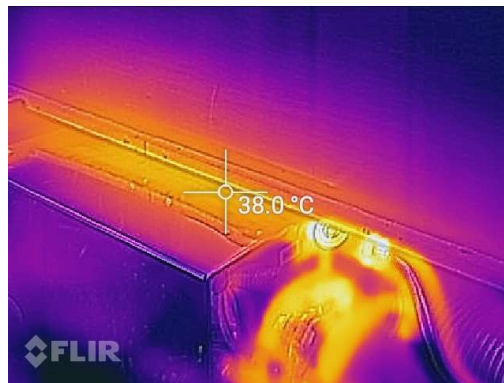
Takole pa s termokamero mojega telefona. Takoj se vidi, kje je izolacija najslabša.
