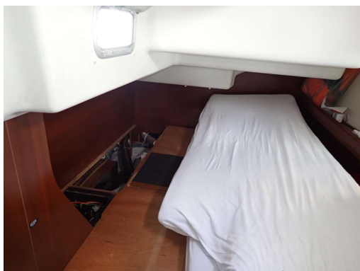
Treba je razdreti postelje, odstraniti podlago in spodaj se prikaže bojler.
