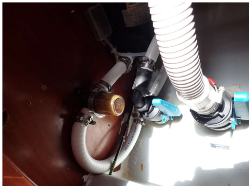
Filter grobih delcev je pod umivalnikom pri ventilih prepustov (skožnikov).
