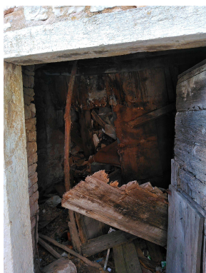
Strop ni več zdržal...
